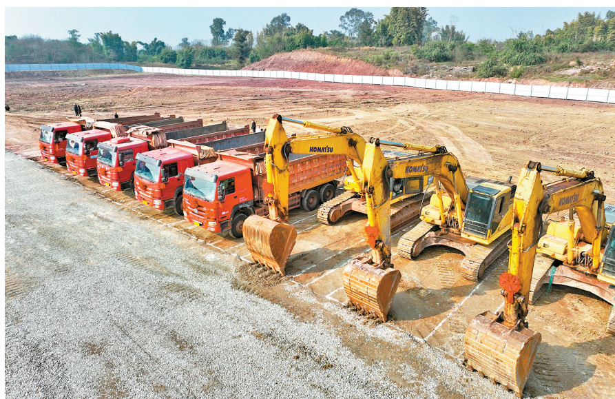
艾斯谱光电先进显示产品生产基地暨隆昌光电科技产业园项目开工仪式现场
